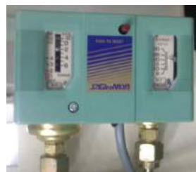
고압경보 발생시 위 DP의 빨강색 버튼을 눌러야 경보가 해제된다.
